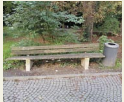
Beschädigte Sitzbank am Kidlerplatz, zur Reparatur empfohlen. Schnell renoviert lädt diese zuvor abstoßende Bank heute zum Verweilen ein.
